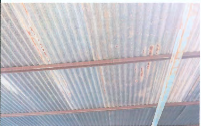
Foto 4: Cubierta dañada de la parte interna.
